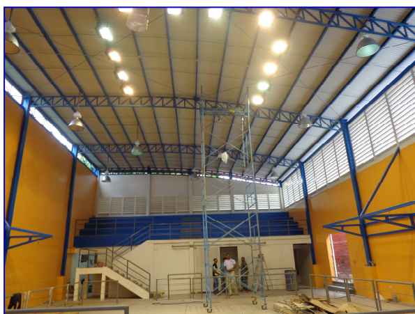
Apreciar vista interna del Gimnasio de Boxeo, donde se aprecia la ejecución de las etapas de electricidad, puertas.
